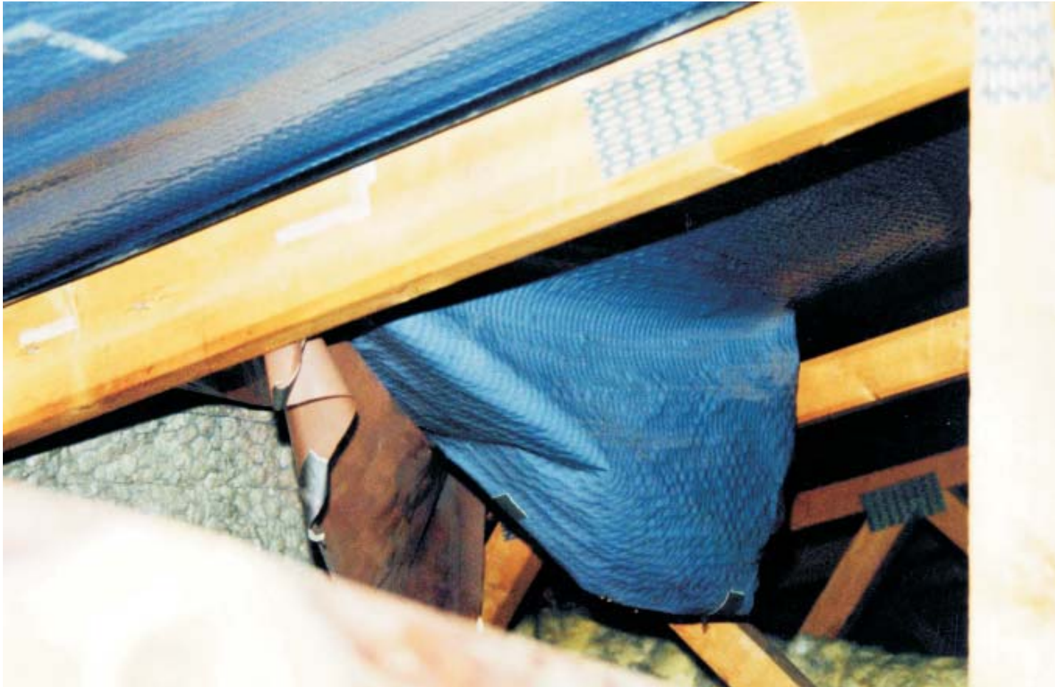
IV-hormin läpiviennistä puuttuu läpivientikaulus.
