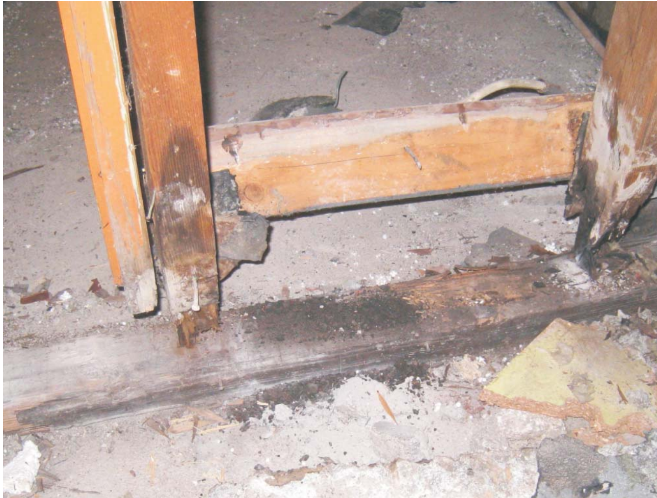
Seinän alaosan kosteusvaurio
